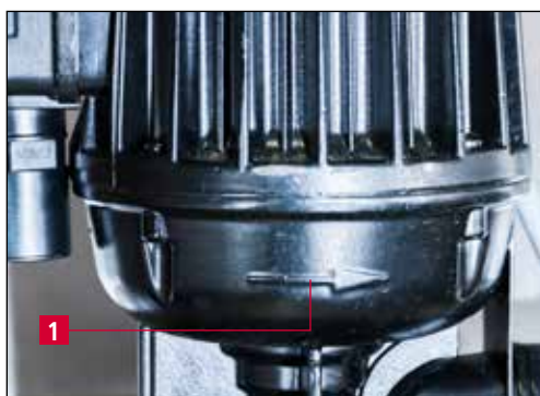
Рис. 6-4 Проверка направления вращения
