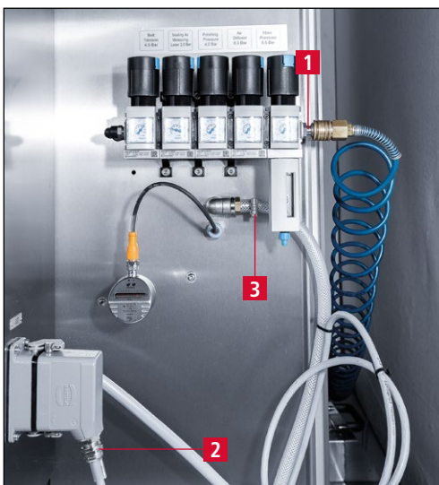
Imagen 6-2 Conexión de aire comprimido
