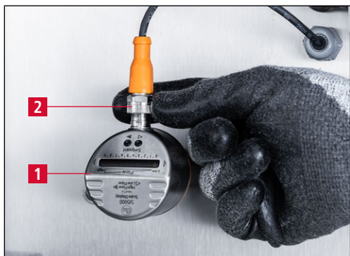
Kuva 9-6 Virtauksen valvontalaitteen kytkeminen irti
